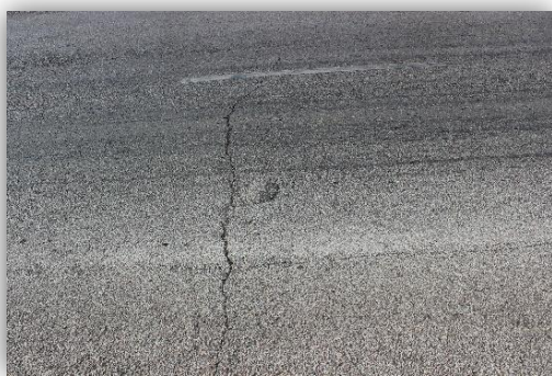
Fig. (4): Transverse Cracking
