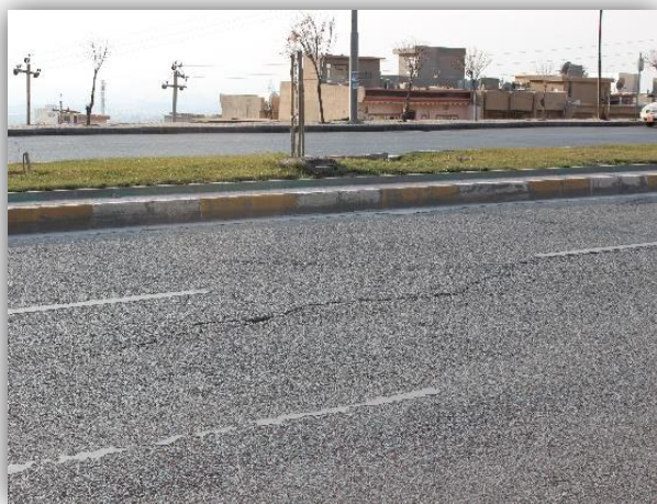
Fig. (3) Longitudinal Cracking
